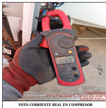
FOTO CORRIENTE REAL EN COMPRESOR
