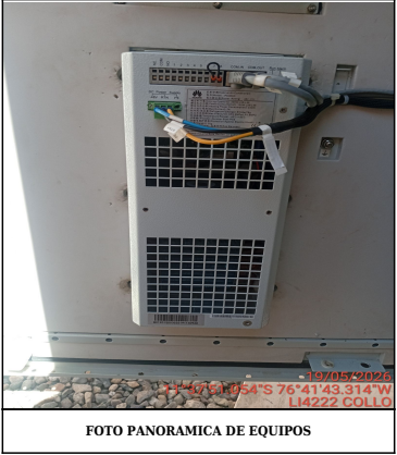
FOTO PANORAMICA DE EQUIPOS
