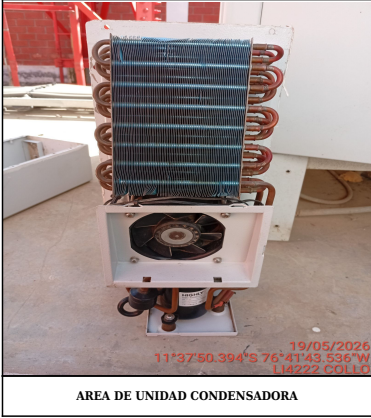
AREA DE UNIDAD CONDENSADORA
