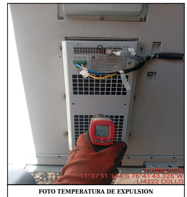
FOTO TEMPERATURA DE EXPULSION
