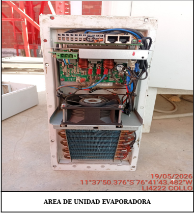
AREA DE UNIDAD EVAPORADORA
