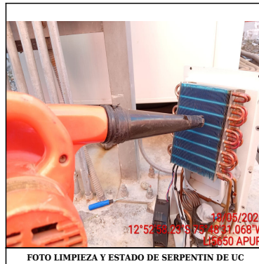
FOTO LIMPIEZA Y ESTADO DE SERPENTIN DE UC
