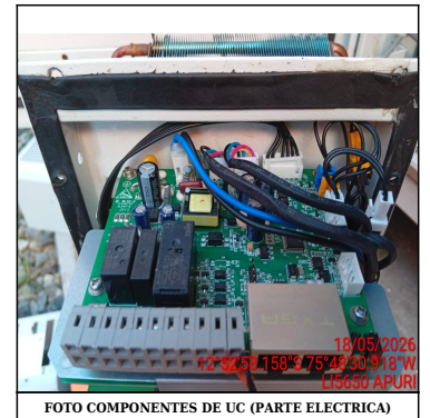
FOTO COMPONENTES DE UC (PARTE ELECTRICA)
