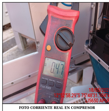
FOTO CORRIENTE REAL EN COMPRESOR
