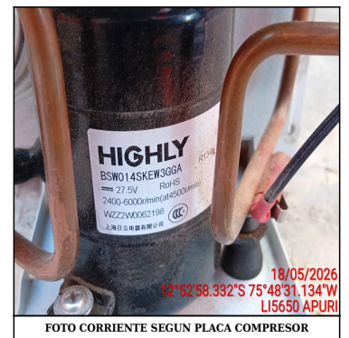
FOTO CORRIENTE SEGUN PLACA COMPRESOR
