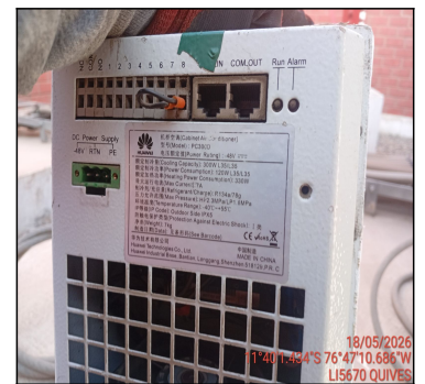
FOTO CORRIENTE SEGUN PLACA COMPRESOR
