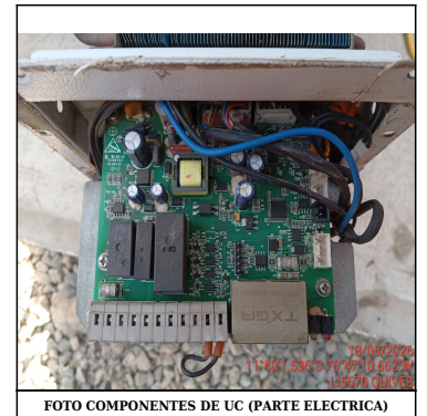
FOTO COMPONENTES DE UC (PARTE ELECTRICA)
