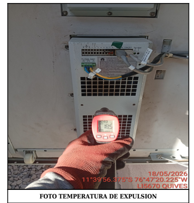
FOTO TEMPERATURA DE EXPULSION
