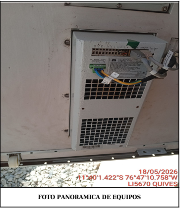
FOTO PANORAMICA DE EQUIPOS
