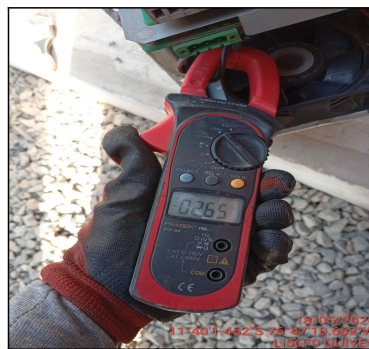
FOTO CORRIENTE REAL EN COMPRESOR
