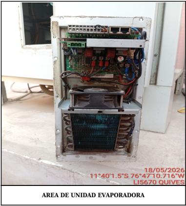
AREA DE UNIDAD EVAPORADORA
