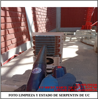
FOTO LIMPIEZA Y ESTADO DE SERPENTIN DE UC
