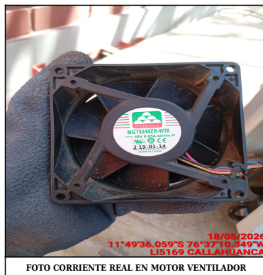
FOTO CORRIENTE REAL EN MOTOR VENTILADOR
