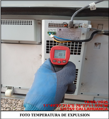
FOTO TEMPERATURA DE EXPULSION
