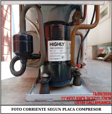
FOTO CORRIENTE SEGUN PLACA COMPRESOR
