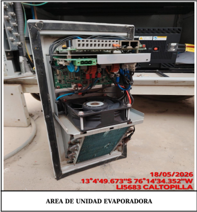
AREA DE UNIDAD EVAPORADORA
