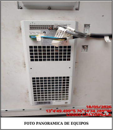
FOTO PANORAMICA DE EQUIPOS
