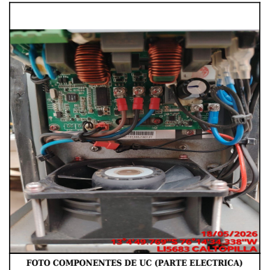
FOTO COMPONENTES DE UC (PARTE ELECTRICA)
