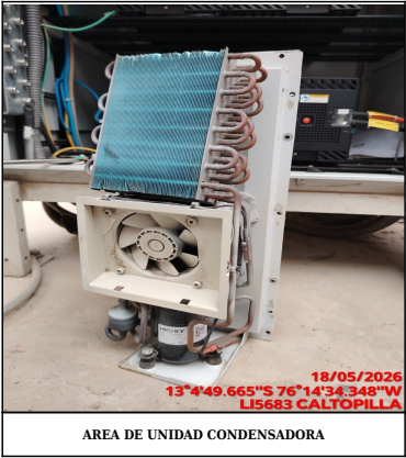
AREA DE UNIDAD CONDENSADORA
