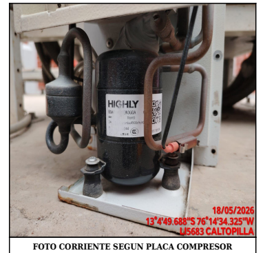
FOTO CORRIENTE SEGUN PLACA COMPRESOR
