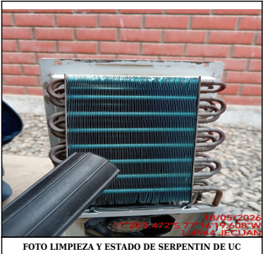
FOTO LIMPIEZA Y ESTADO DE SERPENTIN DE UC
