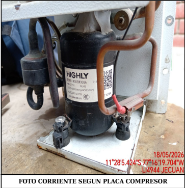
FOTO CORRIENTE SEGUN PLACA COMPRESOR
