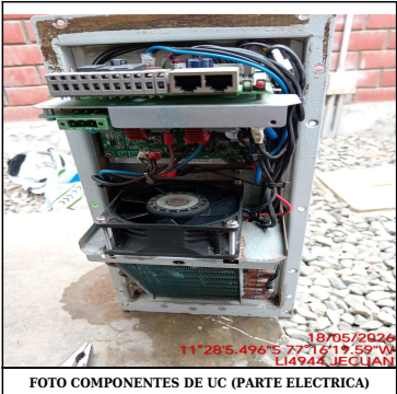
FOTO COMPONENTES DE UC (PARTE ELECTRICA)
