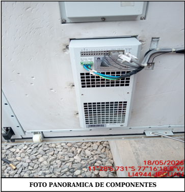
FOTO PANORAMICA DE COMPONENTES
