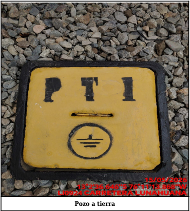
Pozo a tierra
