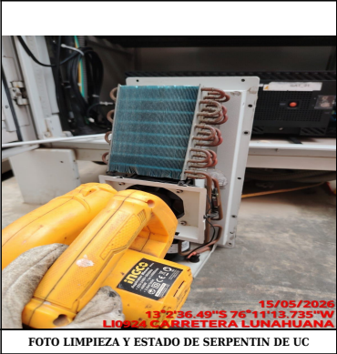
FOTO LIMPIEZA Y ESTADO DE SERPENTIN DE UC
