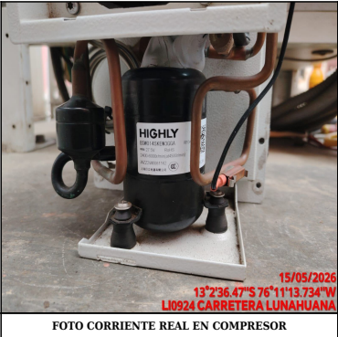
FOTO CORRIENTE REAL EN COMPRESOR
