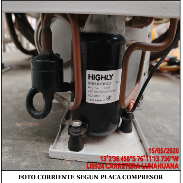
FOTO CORRIENTE SEGUN PLACA COMPRESOR
