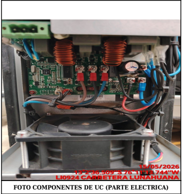
FOTO COMPONENTES DE UC (PARTE ELECTRICA)
