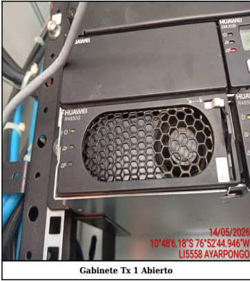
Gabinete Tx 1 Abierto
