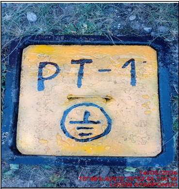
Pozo a tierra
