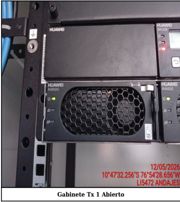
Gabinete Tx 1 Abierto
