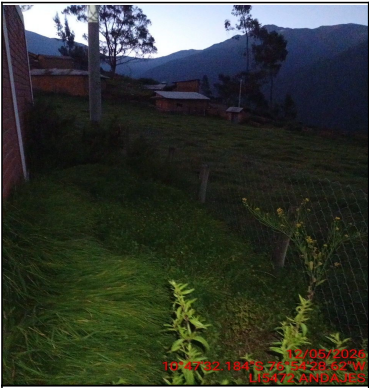
Pozo a tierra
