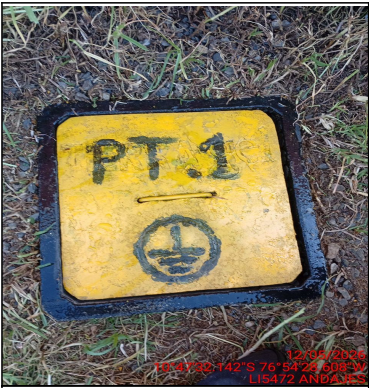
Pozo a tierra
