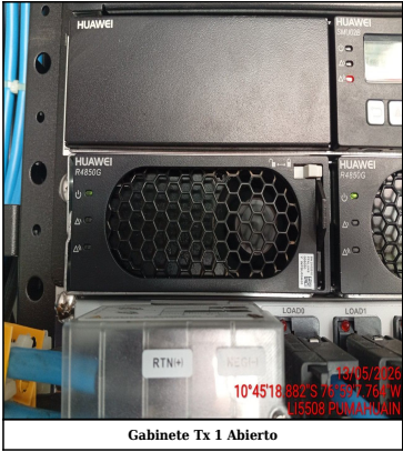
Gabinete Tx 1 Abierto
