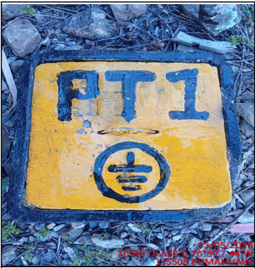
Pozo a tierra
