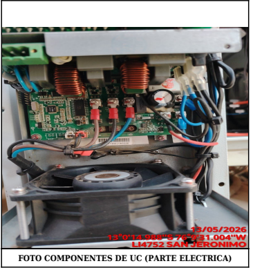
FOTO COMPONENTES DE UC (PARTE ELECTRICA)
