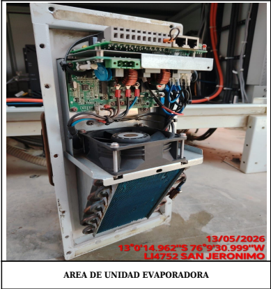
AREA DE UNIDAD EVAPORADORA
