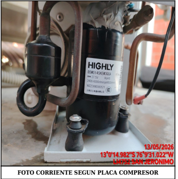
FOTO CORRIENTE SEGUN PLACA COMPRESOR
