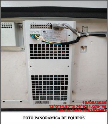
FOTO PANORAMICA DE EQUIPOS
