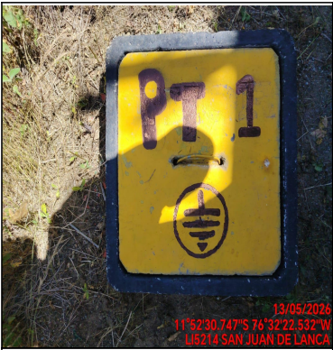
Pozo a tierra
