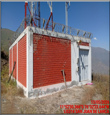
Pozo a tierra
