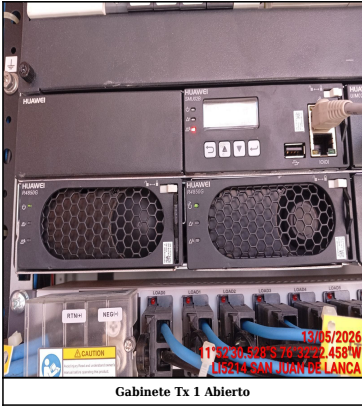
Gabinete Tx 1 Abierto
