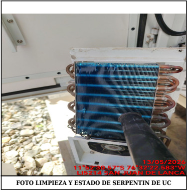
FOTO LIMPIEZA Y ESTADO DE SERPENTIN DE UC
