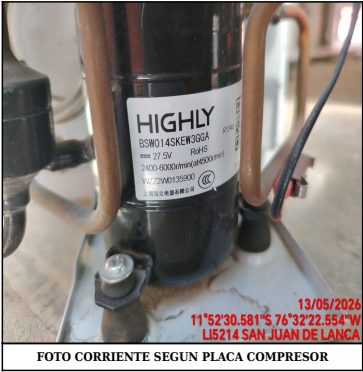
FOTO CORRIENTE SEGUN PLACA COMPRESOR
