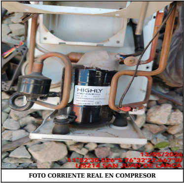
FOTO CORRIENTE REAL EN COMPRESOR
