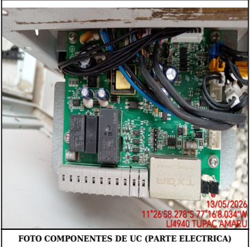
FOTO COMPONENTES DE UC (PARTE ELECTRICA)
