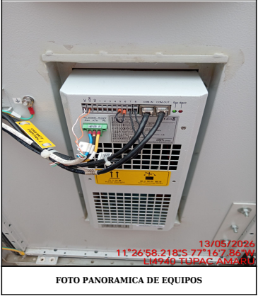
FOTO PANORAMICA DE EQUIPOS
