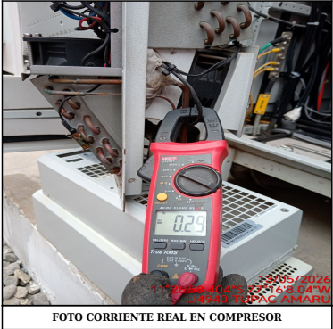
FOTO CORRIENTE REAL EN COMPRESOR
