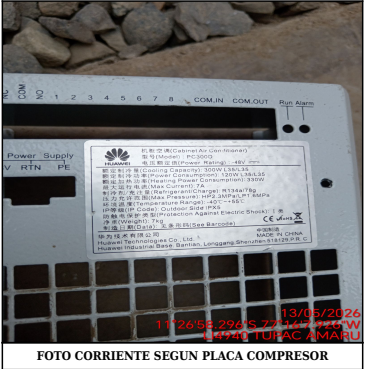
FOTO CORRIENTE SEGUN PLACA COMPRESOR
