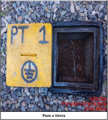
Pozo a tierra
