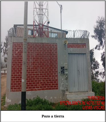
Pozo a tierra
