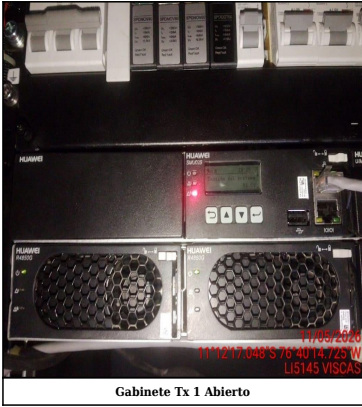
Gabinete Tx 1 Abierto
