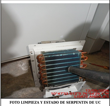
FOTO LIMPIEZA Y ESTADO DE SERPENTIN DE UC
