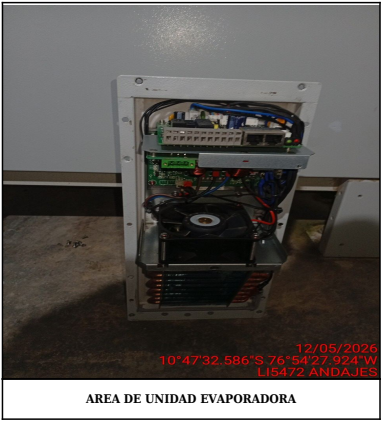
AREA DE UNIDAD EVAPORADORA
