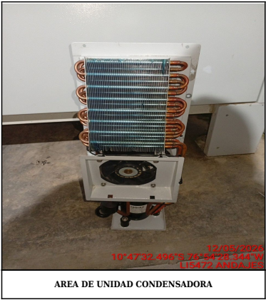
AREA DE UNIDAD CONDENSADORA
