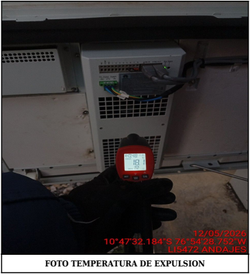
FOTO TEMPERATURA DE EXPULSION
