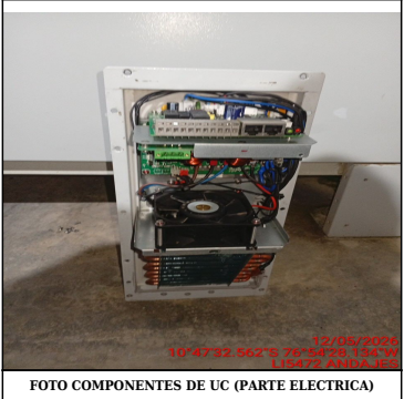
FOTO COMPONENTES DE UC (PARTE ELECTRICA)
