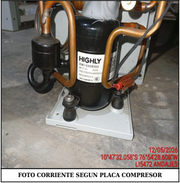
FOTO CORRIENTE SEGUN PLACA COMPRESOR
