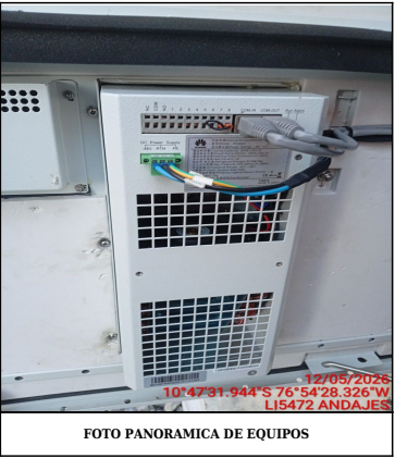
FOTO PANORAMICA DE EQUIPOS
