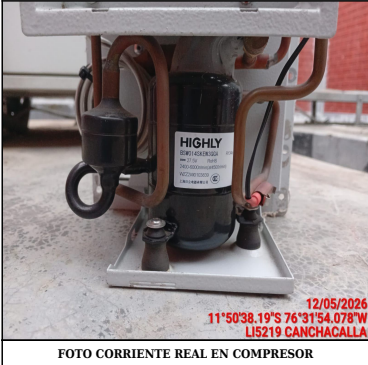
FOTO CORRIENTE REAL EN COMPRESOR
