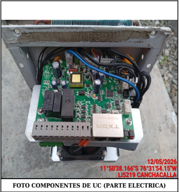
FOTO COMPONENTES DE UC (PARTE ELECTRICA)
