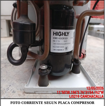
FOTO CORRIENTE SEGUN PLACA COMPRESOR
