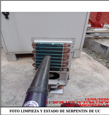
FOTO LIMPIEZA Y ESTADO DE SERPENTIN DE UC
