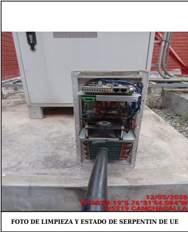
FOTO DE LIMPIEZA Y ESTADO DE SERPENTIN DE UE
