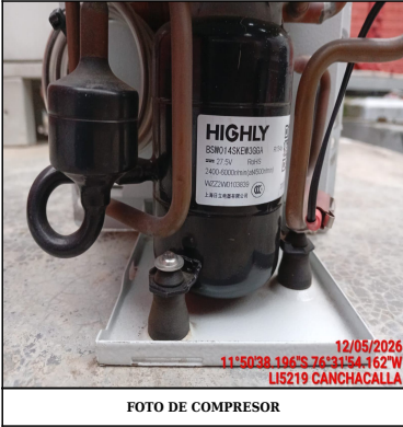
FOTO DE COMPRESOR
