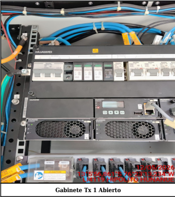
Gabinete Tx 1 Abierto
