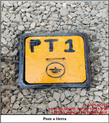
Pozo a tierra
