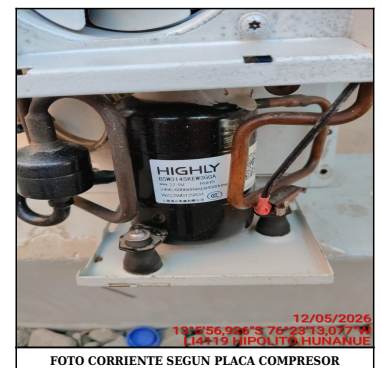
FOTO CORRIENTE SEGUN PLACA COMPRESOR
