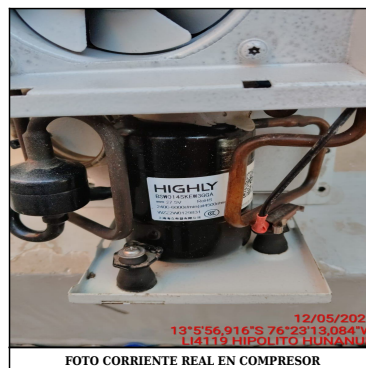
FOTO CORRIENTE REAL EN COMPRESOR
