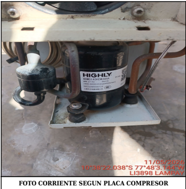
FOTO CORRIENTE SEGUN PLACA COMPRESOR
