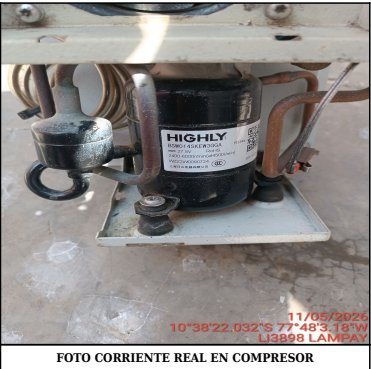
FOTO CORRIENTE REAL EN COMPRESOR
