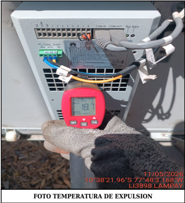
FOTO TEMPERATURA DE EXPULSION
