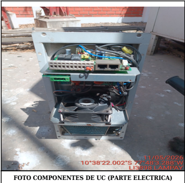
FOTO COMPONENTES DE UC (PARTE ELECTRICA)
