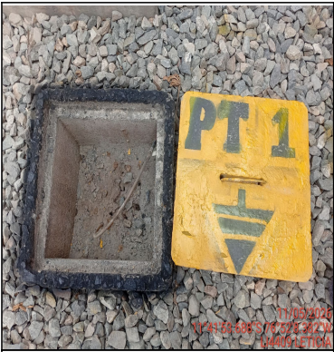
Pozo a tierra
