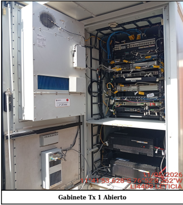
Gabinete Tx 1 Abierto
