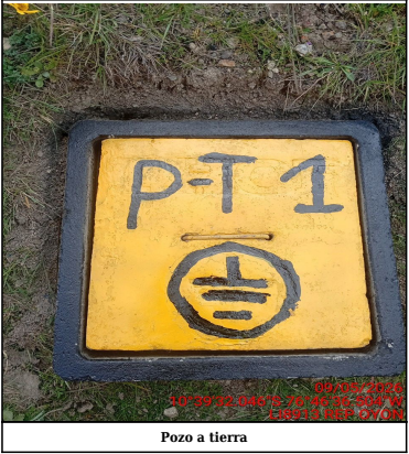
Pozo a tierra
