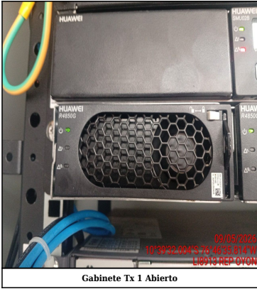
Gabinete Tx 1 Abierto
