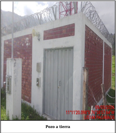
Pozo a tierra
