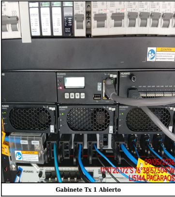
Gabinete Tx 1 Abierto
