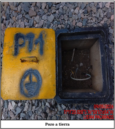
Pozo a tierra
