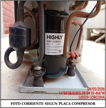
FOTO CORRIENTE SEGUN PLACA COMPRESOR
