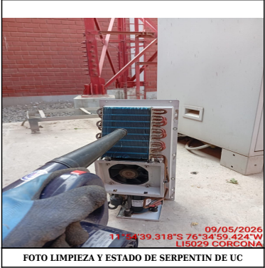
FOTO LIMPIEZA Y ESTADO DE SERPENTIN DE UC
