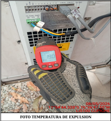
FOTO TEMPERATURA DE EXPULSION
