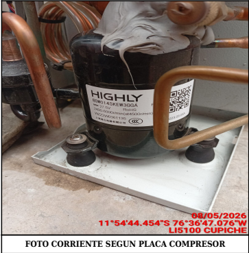
FOTO CORRIENTE SEGUN PLACA COMPRESOR
