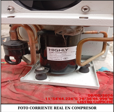
FOTO CORRIENTE REAL EN COMPRESOR
