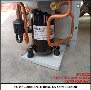
FOTO CORRIENTE REAL EN COMPRESOR
