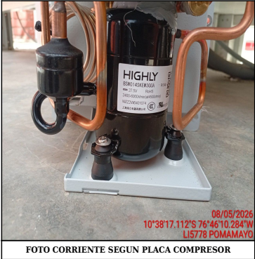
FOTO CORRIENTE SEGUN PLACA COMPRESOR
