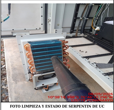
FOTO LIMPIEZA Y ESTADO DE SERPENTIN DE UC
