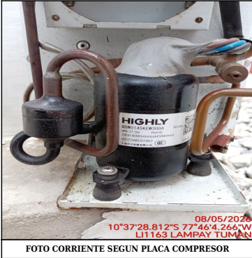
FOTO CORRIENTE SEGUN PLACA COMPRESOR
