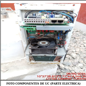
FOTO COMPONENTES DE UC (PARTE ELECTRICA)
