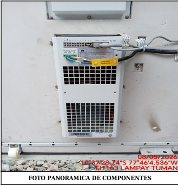
FOTO PANORAMICA DE COMPONENTES
