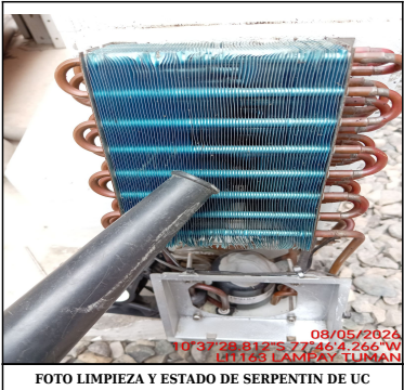
FOTO LIMPIEZA Y ESTADO DE SERPENTIN DE UC
