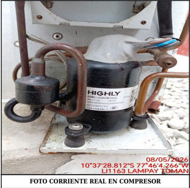
FOTO CORRIENTE REAL EN COMPRESOR
