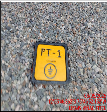
Pozo a tierra
