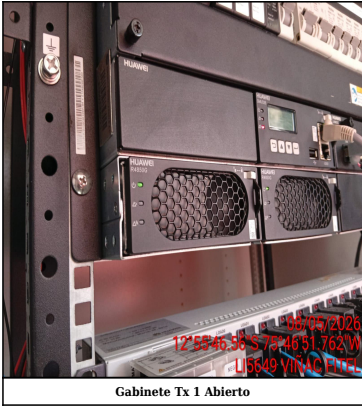
Gabinete Tx Abierto
