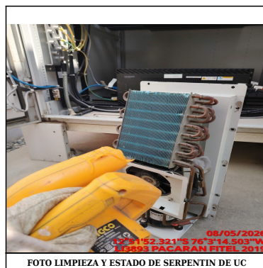
FOTO LIMPIEZA Y ESTADO DE SERPENTIN DE UC
