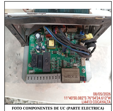
FOTO COMPONENTES DE UC (PARTE ELECTRICA)
