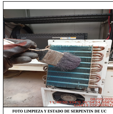
FOTO LIMPIEZA Y ESTADO DE SERPENTIN DE UC
