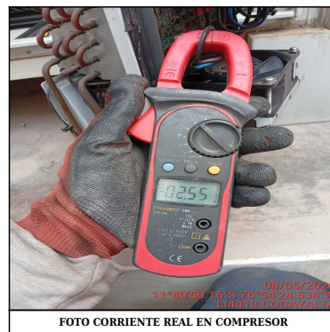
FOTO CORRIENTE REAL EN COMPRESOR
