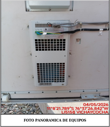
FOTO PANORAMICA DE EQUIPOS
