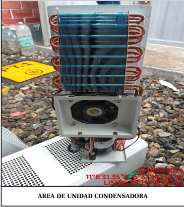
AREA DE UNIDAD CONDENSADORA
