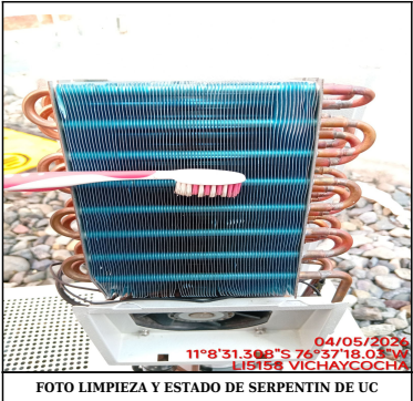
FOTO LIMPIEZA Y ESTADO DE SERPENTIN DE UC
