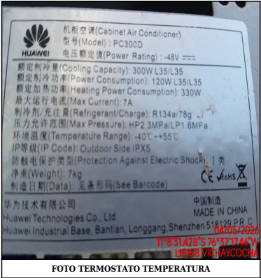
FOTO TERMOSTATO TEMPERATURA
