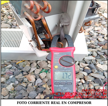
FOTO CORRIENTE REAL EN COMPRESOR
