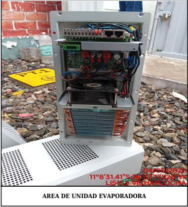
AREA DE UNIDAD EVAPORADORA
