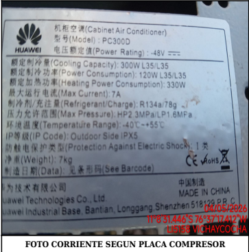
FOTO CORRIENTE SEGUN PLACA COMPRESOR
