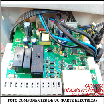
FOTO COMPONENTES DE UC (PARTE ELECTRICA)
