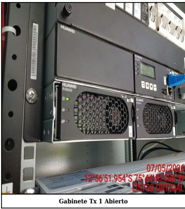
Gabinete Tx 1 Abierto
