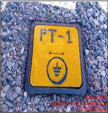
Pozo a tierra
