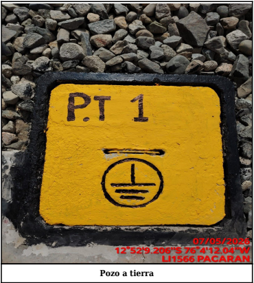
Pozo a tierra
