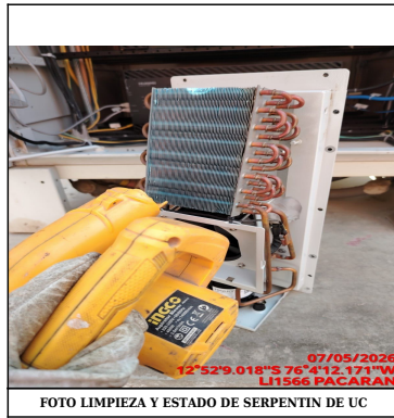
FOTO LIMPIEZA Y ESTADO DE SERPENTIN DE UC
