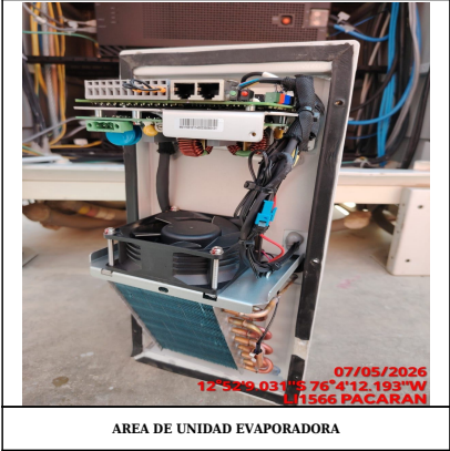
AREA DE UNIDAD EVAPORADORA
