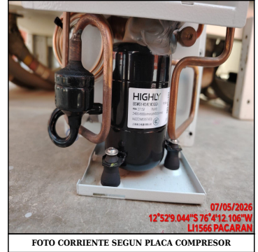
FOTO CORRIENTE SEGUN PLACA COMPRESOR
