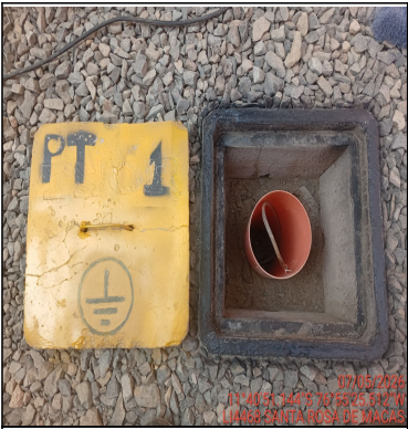
Pozo a tierra
