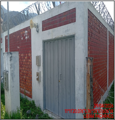
Pozo a tierra
