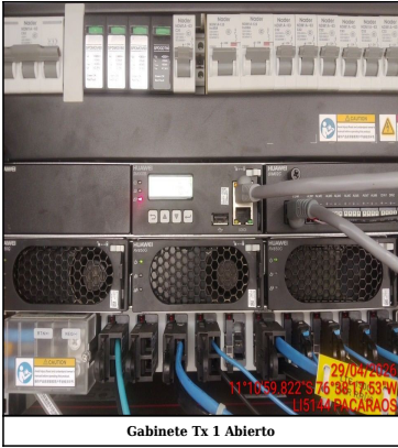
Gabinete Tx 1 Abierto
