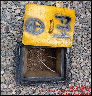
Pozo a tierra
