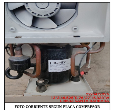
FOTO CORRIENTE SEGUN PLACA COMPRESOR
