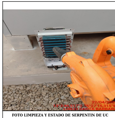
FOTO LIMPIEZA Y ESTADO DE SERPENTIN DE UC
