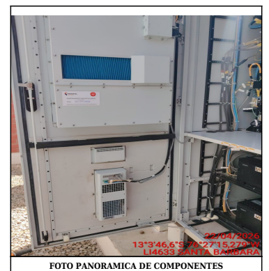
FOTO PANORAMICA DE COMPONENTES
