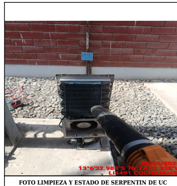
FOTO LIMPIEZA Y ESTADO DE SERPENTIN DE UC
