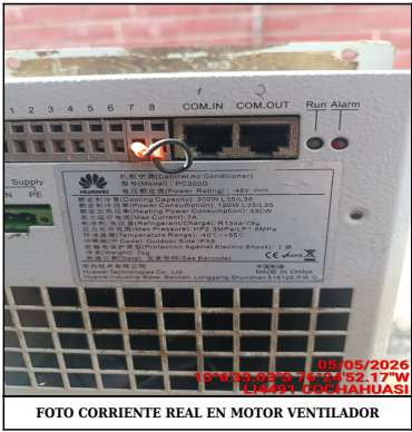
FOTO CORRIENTE REAL EN MOTOR VENTILADOR
