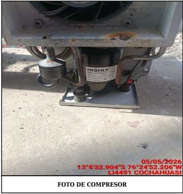
FOTO DE COMPRESOR
