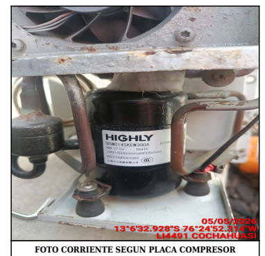
FOTO CORRIENTE SEGUN PLACA COMPRESOR
