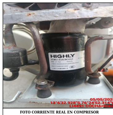
FOTO CORRIENTE REAL EN COMPRESOR
