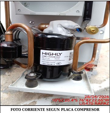
FOTO CORRIENTE SEGUN PLACA COMPRESOR
