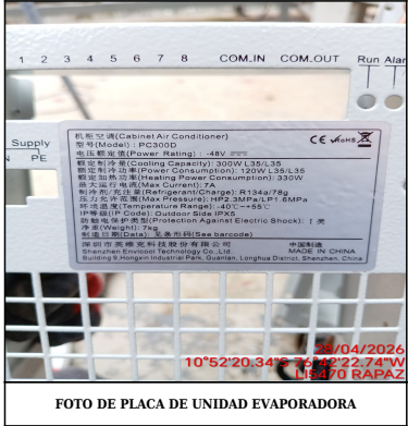
FOTO DE PLACA DE UNIDAD EVAPORADORA
