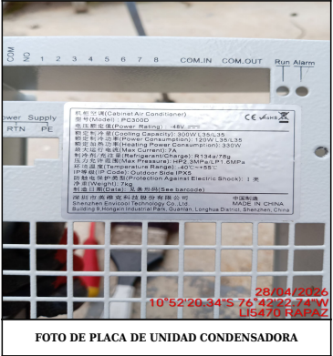
FOTO DE PLACA DE UNIDAD CONDENSADORA
