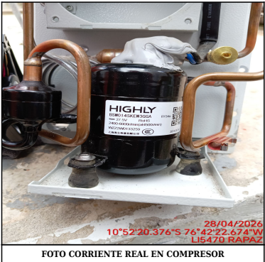
FOTO CORRIENTE REAL EN COMPRESOR
