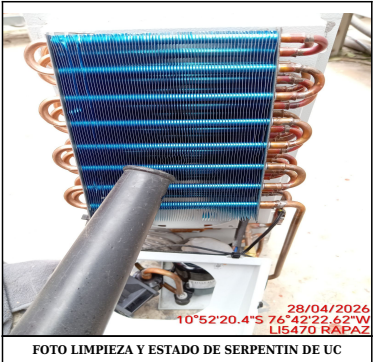
FOTO LIMPIEZA Y ESTADO DE SERPENTIN DE UC
