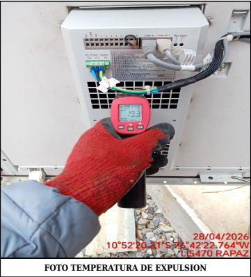
FOTO TEMPERATURA DE EXPULSION
