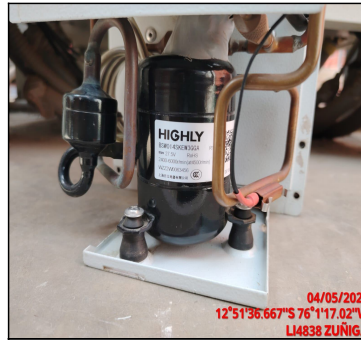
FOTO CORRIENTE REAL EN COMPRESOR
