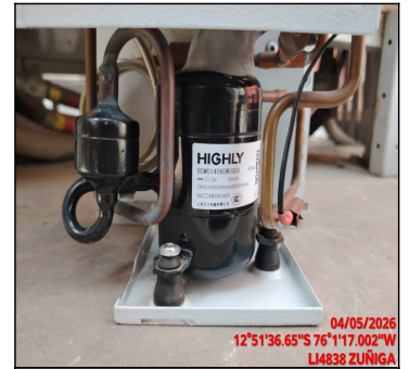
FOTO CORRIENTE SEGUN PLACA COMPRESOR
