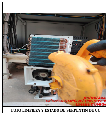
FOTO LIMPIEZA Y ESTADO DE SERPENTIN DE UC
