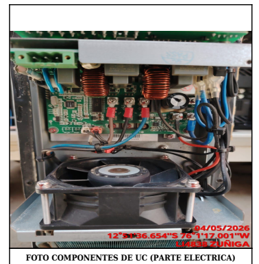
FOTO COMPONENTES DE UC (PARTE ELECTRICA)
