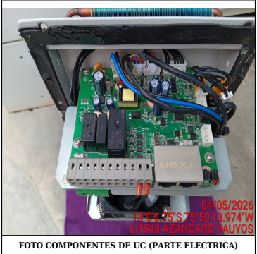
FOTO COMPONENTES DE UC (PARTE ELECTRICA)
