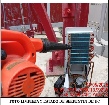
FOTO LIMPIEZA Y ESTADO DE SERPENTIN DE UC
