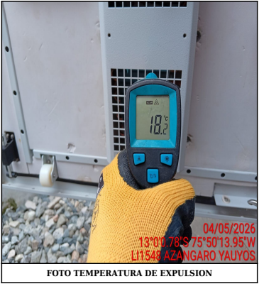
FOTO TEMPERATURA DE EXPULSION
