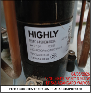
FOTO CORRIENTE SEGUN PLACA COMPRESOR
