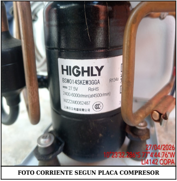
FOTO CORRIENTE SEGUN PLACA COMPRESOR
