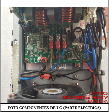
FOTO COMPONENTES DE UC (PARTE ELECTRICA)
