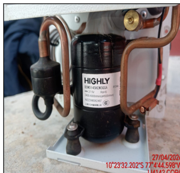
FOTO DE COMPRESOR
