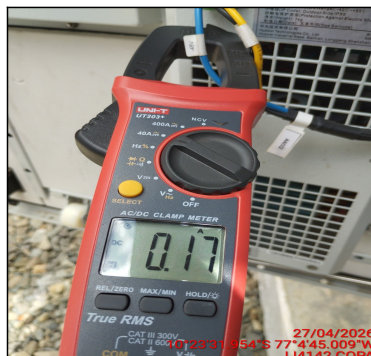
FOTO CORRIENTE REAL EN MOTOR VENTILADOR
