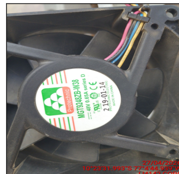
FOTO CORRIENTE SEGUN PLACA EN MOTOR VENTILADOR
