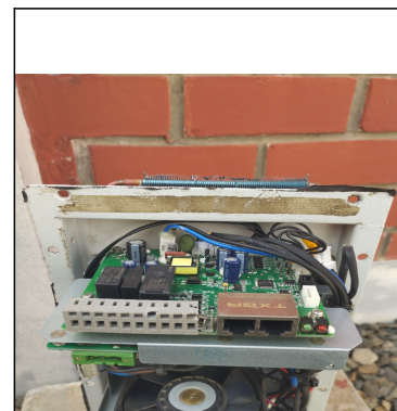
FOTO DE COMPONENTES DE UE (PARTE ELECTRICA)
