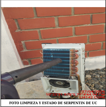
FOTO LIMPIEZA Y ESTADO DE SERPENTIN DE UC
