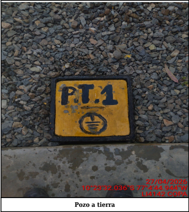
Pozo a tierra
