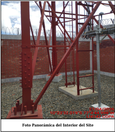
Foto Panorámica del Interior del Site
