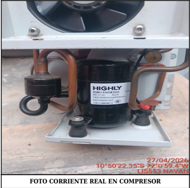
FOTO CORRIENTE REAL EN COMPRESOR
