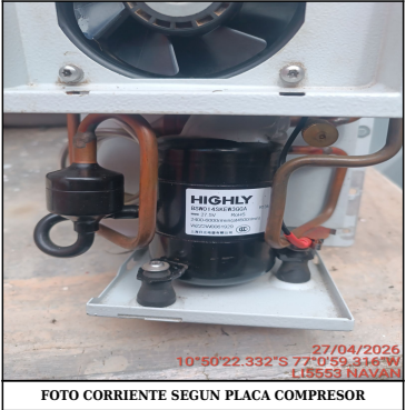
FOTO CORRIENTE SEGUN PLACA COMPRESOR
