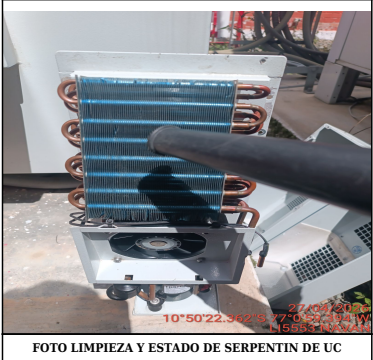
FOTO LIMPIEZA Y ESTADO DE SERPENTIN DE UC
