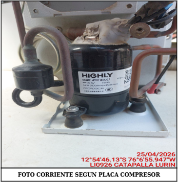
FOTO CORRIENTE SEGUN PLACA COMPRESOR
