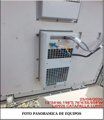
FOTO PANORAMICA DE EQUIPOS
