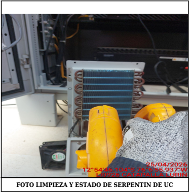
FOTO LIMPIEZA Y ESTADO DE SERPENTIN DE UC
