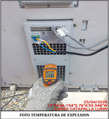
FOTO TEMPERATURA DE EXPULSION
