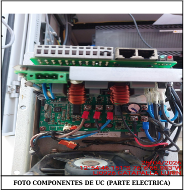
FOTO COMPONENTES DE UC (PARTE ELECTRICA)
