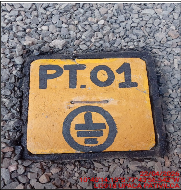
Pozo a tierra
