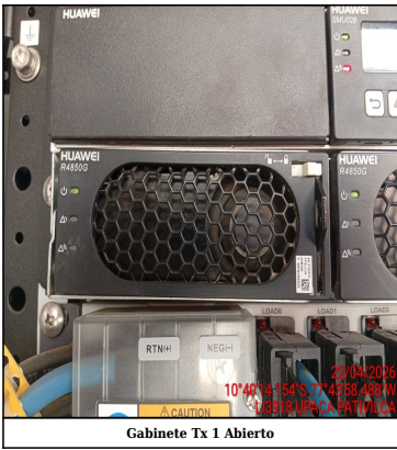
Gabinete Tx 1 Abierto
