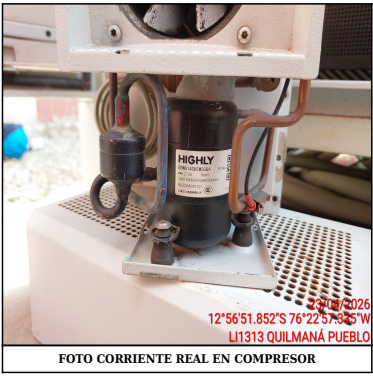
FOTO CORRIENTE REAL EN COMPRESOR
