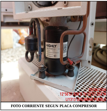
FOTO CORRIENTE SEGUN PLACA COMPRESOR
