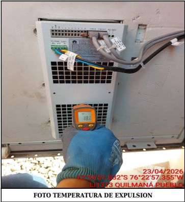
FOTO TEMPERATURA DE EXPULSION
