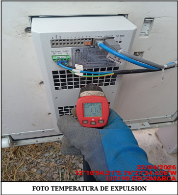
FOTO TEMPERATURA DE EXPULSION
