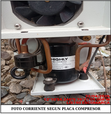
FOTO CORRIENTE SEGUN PLACA COMPRESOR
