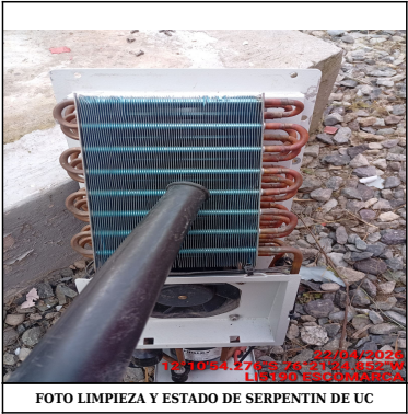
FOTO LIMPIEZA Y ESTADO DE SERPENTIN DE UC
