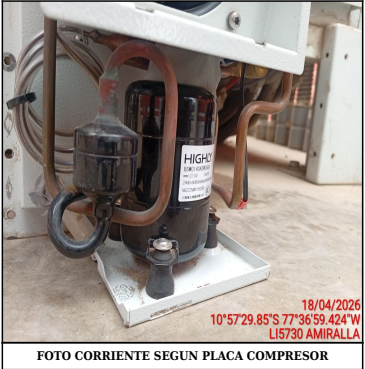
FOTO CORRIENTE SEGUN PLACA COMPRESOR
