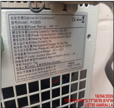
FOTO DE PLACA DE UNIDAD EVAPORADORA
