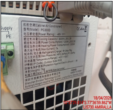
FOTO DE PLACA DE UNIDAD CONDENSADORA
