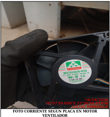
FOTO CORRIENTE SEGUN PLACA EN MOTOR VENTILADOR
