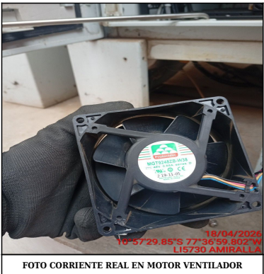
FOTO CORRIENTE REAL EN MOTOR VENTILADOR
