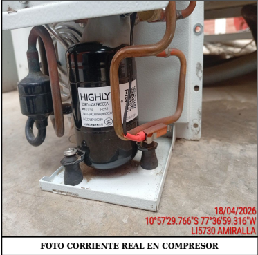
FOTO CORRIENTE REAL EN COMPRESOR
