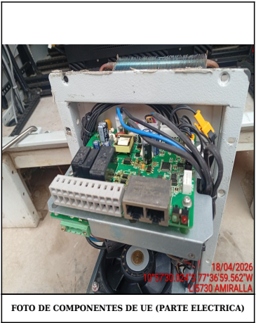
FOTO DE COMPONENTES DE UE (PARTE ELECTRICA)
